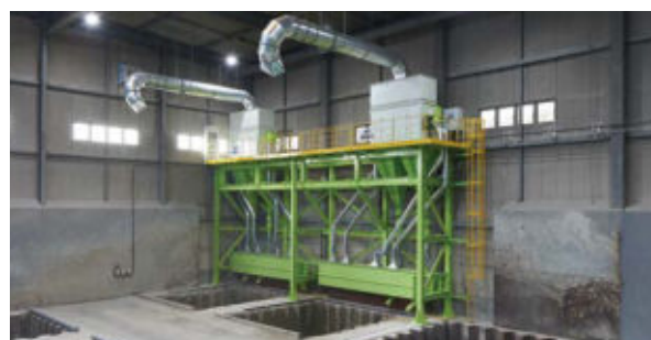
建屋内の局所集塵機
