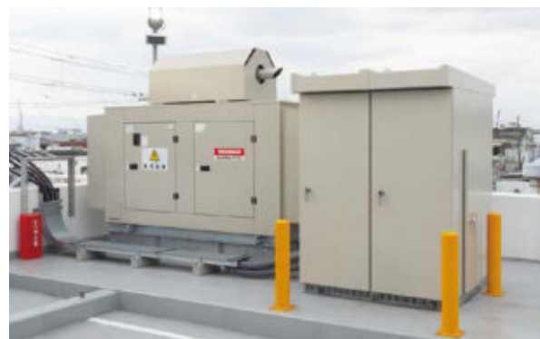
立体駐車場最上階に設置された大容量の自家発電機
