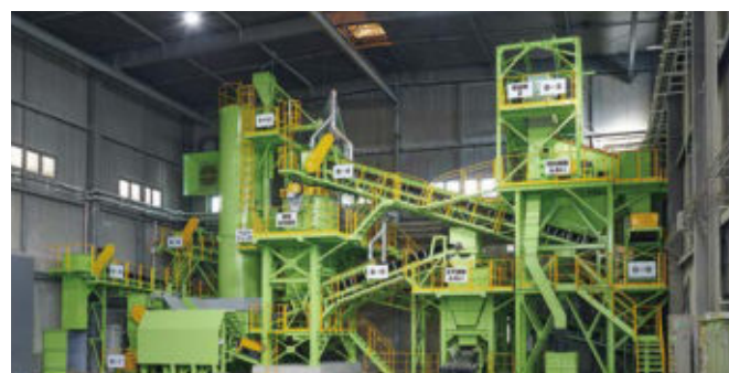
建屋内の固化再生施設
