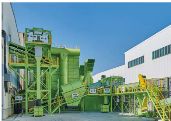
固化再生施設(屋外部分)大型集塵機等
