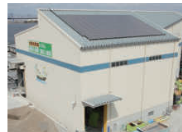
保管倉庫の屋根を利用しソーラー発電を行う
