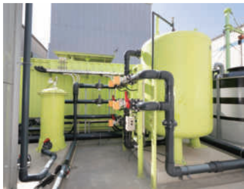
砂ろ過装置とチェックフィルター。奥が海水淡水化装置のコンテナ
