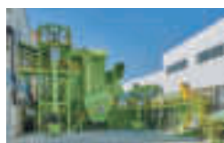
固化再生施設 (屋外部分) 大型集塵機等
