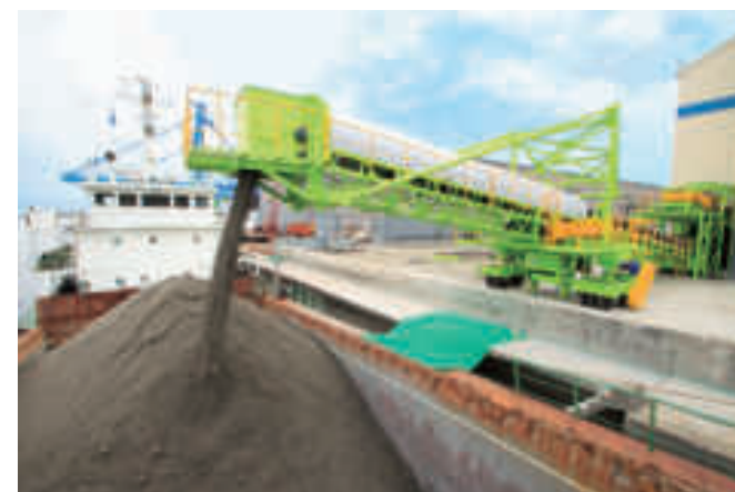
保管倉庫から船舶へ再生土の搬出を行う専用バース（停泊場所）
