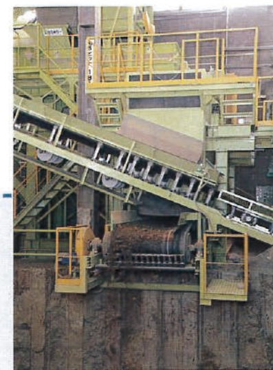
粒度調整篩・製品保管ピット
