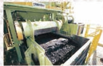
土砂脱水機 No.1
