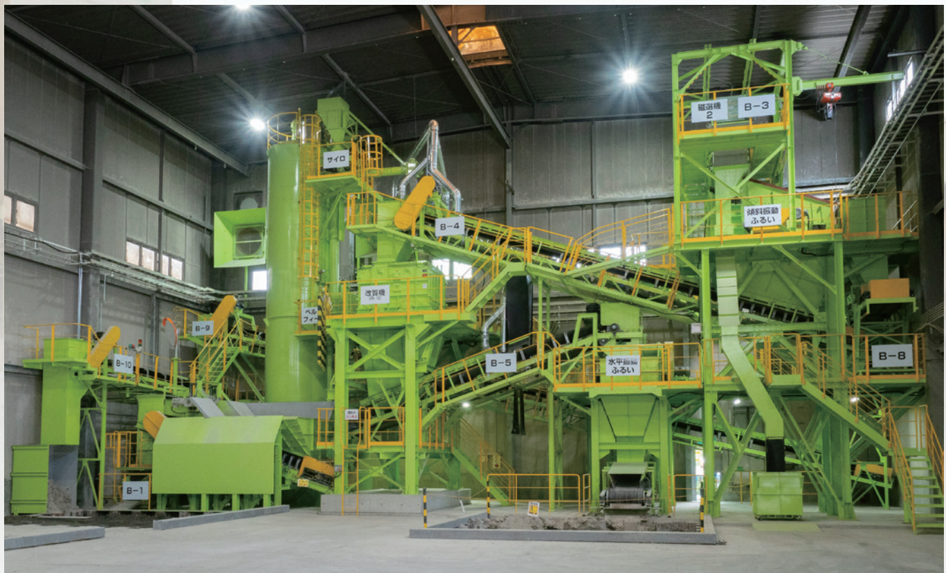
固化再生施設（建屋内）
