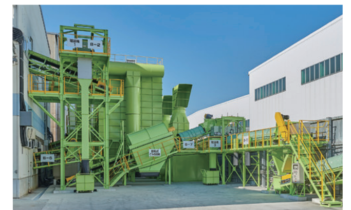
固化再生施設（屋外部分）
