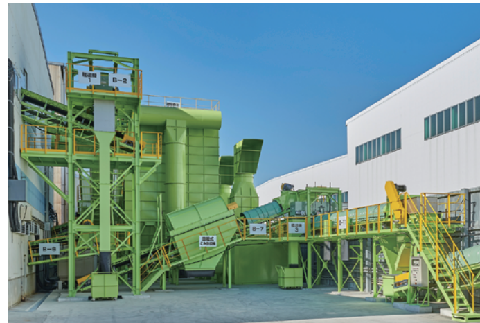
固化再生施設（屋外部分）大型集塵機等
