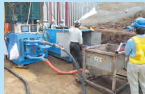
中継ポンプの使用
