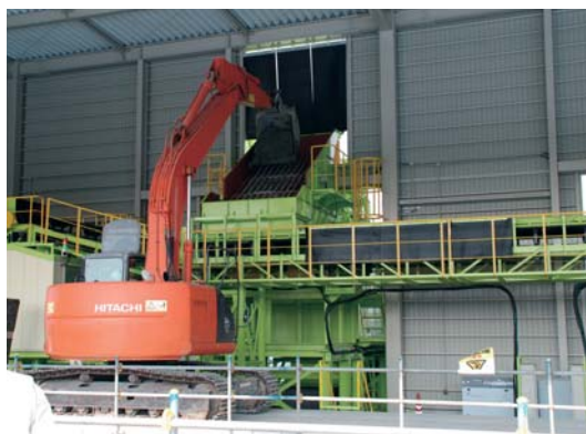
中性固化施設
