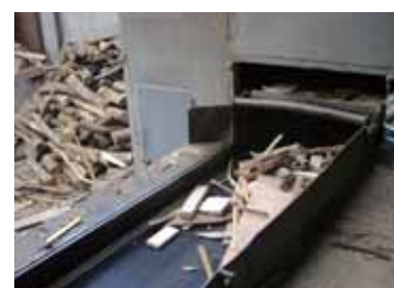
ハンマーミルへの投入口
