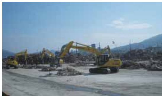
震災廃棄物処理(分別)施設
