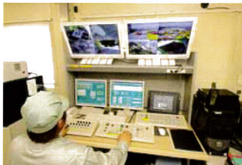
コントロールセンター
